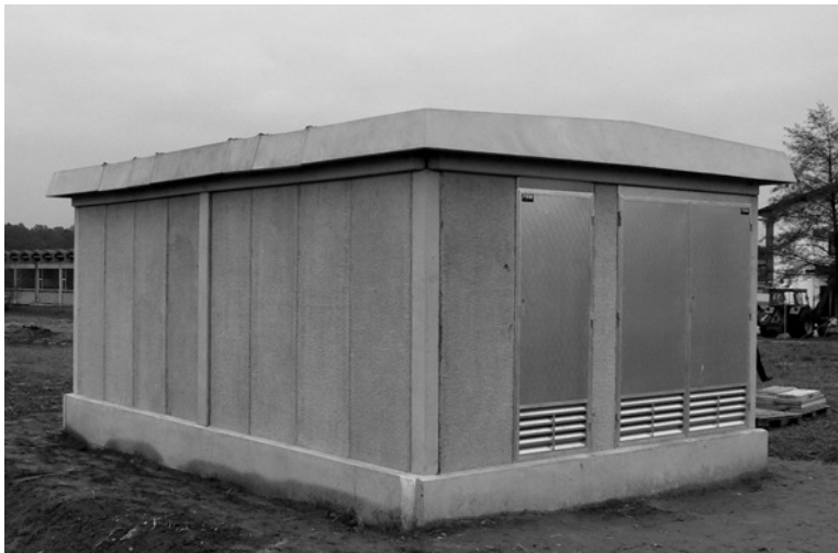
Slika 12: Betonska transformatorska postaja s klasično betonsko streho
